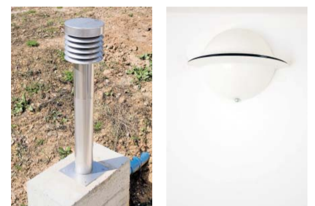
Durch das Ansaugrohr im Garten kommt die Luft ins Haus, wird erwärmt und oben in den Räumen ausgeblasen
